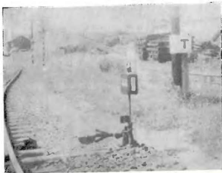
15. Schránka se služebním telefonem na sloupi v posunovacím obvodu
